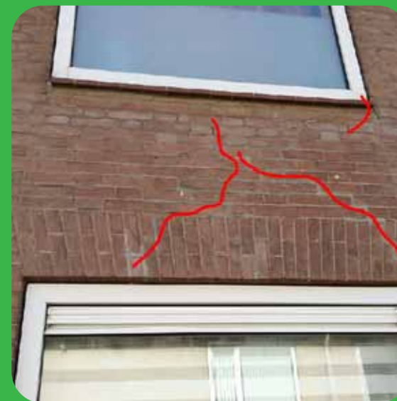
Diverse scheuren zichtbaar
